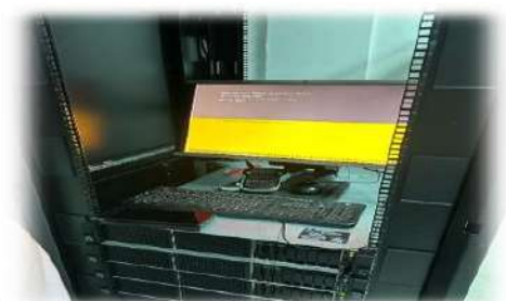
Un Data center
