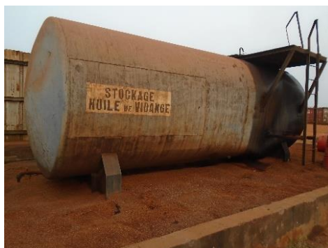
Photo1 : Cuve de stockage des huiles usées (IFO)
